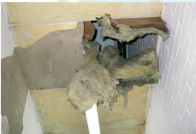
DERRUMBE DE TECHOS.
